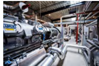
◀ Condensador evaporativo de amoniaco.
