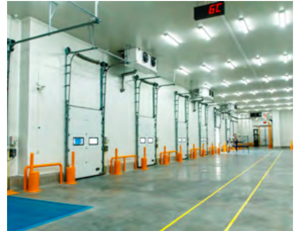
▲ Zona de expedición en almacén refrigerado.
