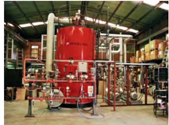
▲ Caldera de fluido térmico para industria alimentaria.
