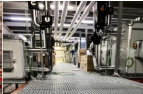
< Rociadores contra incendios en planta industrial.
